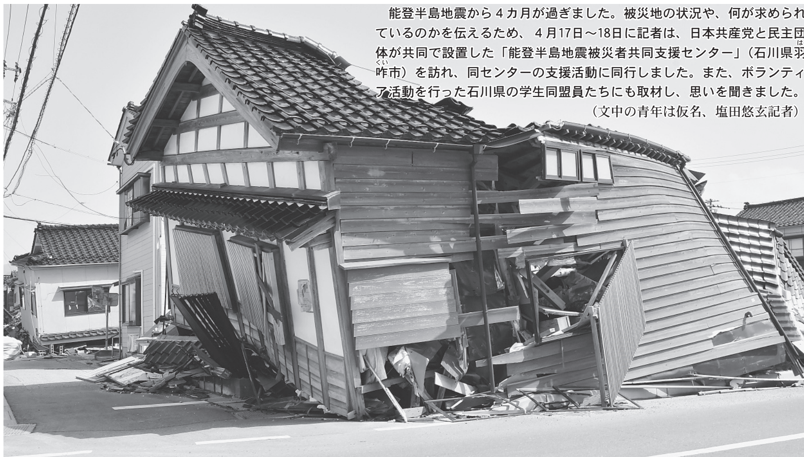
▶ 能登半島地震によって壊れた家屋(4月17日、輪島市)
